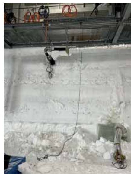
Pipeline vecchia e nuova
